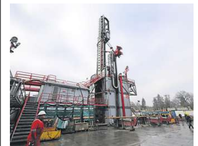
Eine Anlage für Tiefengeothermie steht an der Heinrich-Mann-Allee.
